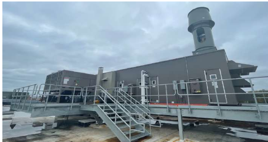
※ 空調システム（エネルギーリカバリーユニット）
